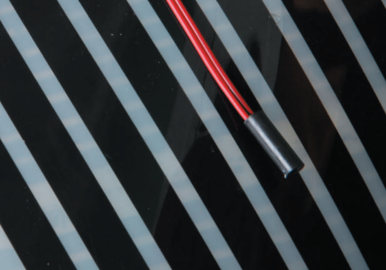
Рис. 22. Установка датчика температуры пола SF 4x15
