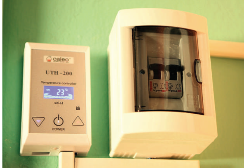
Рис. 27. Терморегулятор, подключенный к сети через отдельный автомат
